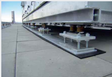
Installation VMC sur toit avec efforts liés au vent élevés
