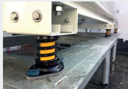
Évaporateur installé sur toit
