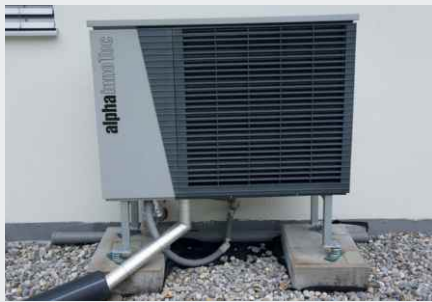
Unité extérieure de pompe à chaleur
