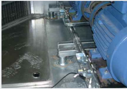
Isolation de ventilateurs à entraînement par courroie
